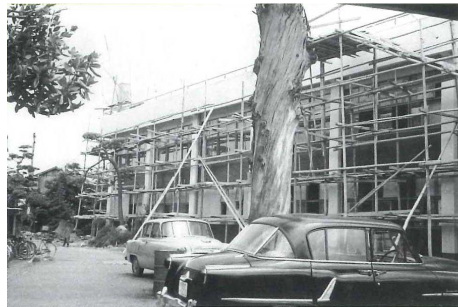
昭和37年 第一期工事中の管理棟（中央の巨木は火災で傷んだユーカリ）
